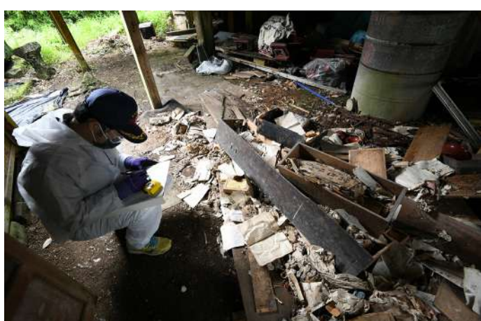
母屋と納屋をつなぐ建物天井が破損し、資料が地面に散乱している状態。大まかな分布図を作製してから回収した。
